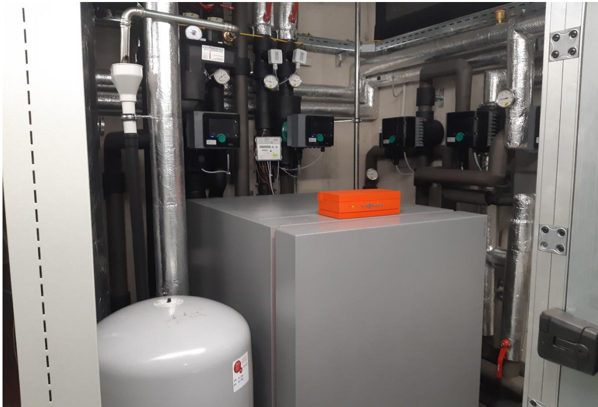
Abbildung 3: Der Blick in die Haustechnik-Zentrale
