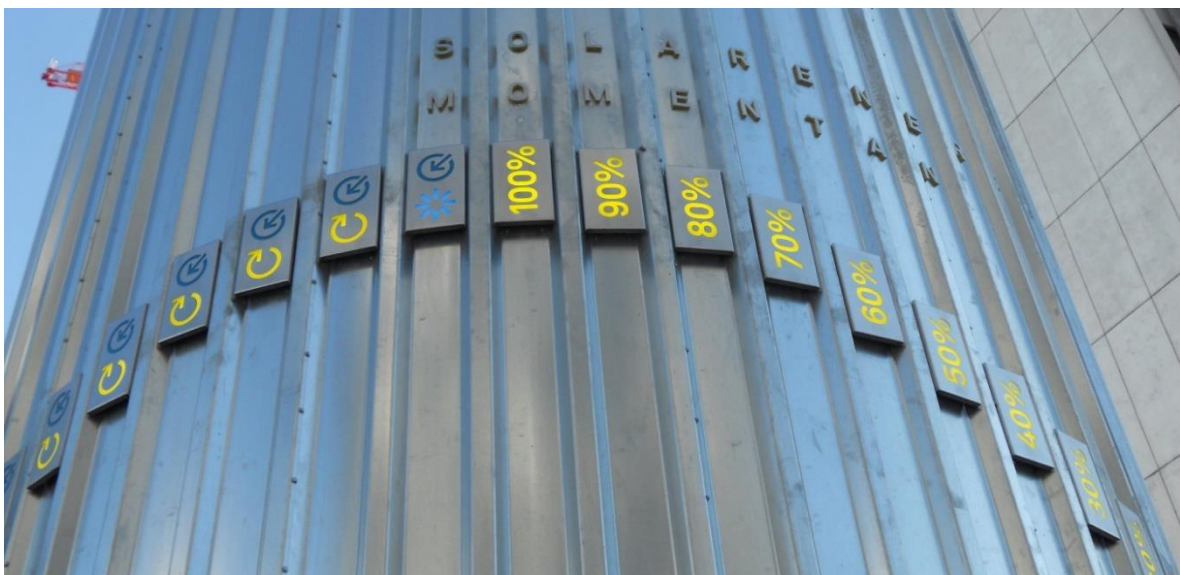
Abbildung 2: Solar-Pufferspeicher 200.000 Liter mitten im Stadtwerk Lehen
