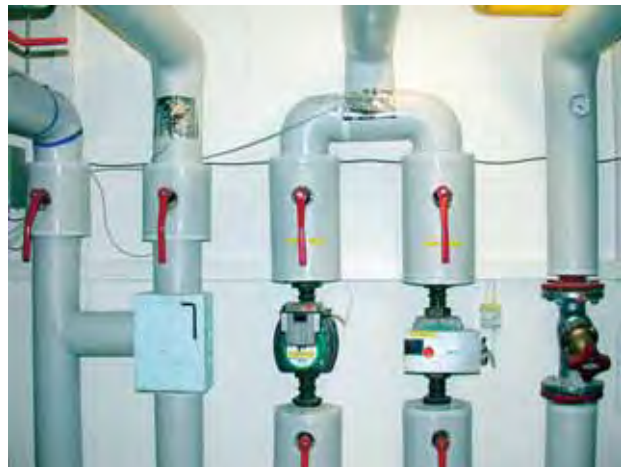
▲ Armaturendämmung sollte Standard in modernen Wärmeversorgungssystemen sein.
