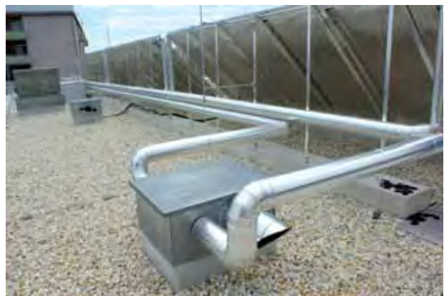
▲ Temperaturbeständige und feuchteabweisende Rohrdämmung mit Glanzblechummantelung als Standard im Außenbereich.
