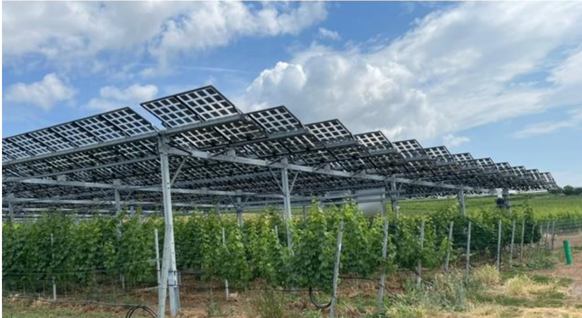
Abbildung 1: Typische Agri- PV-Anlage im Weinbau
