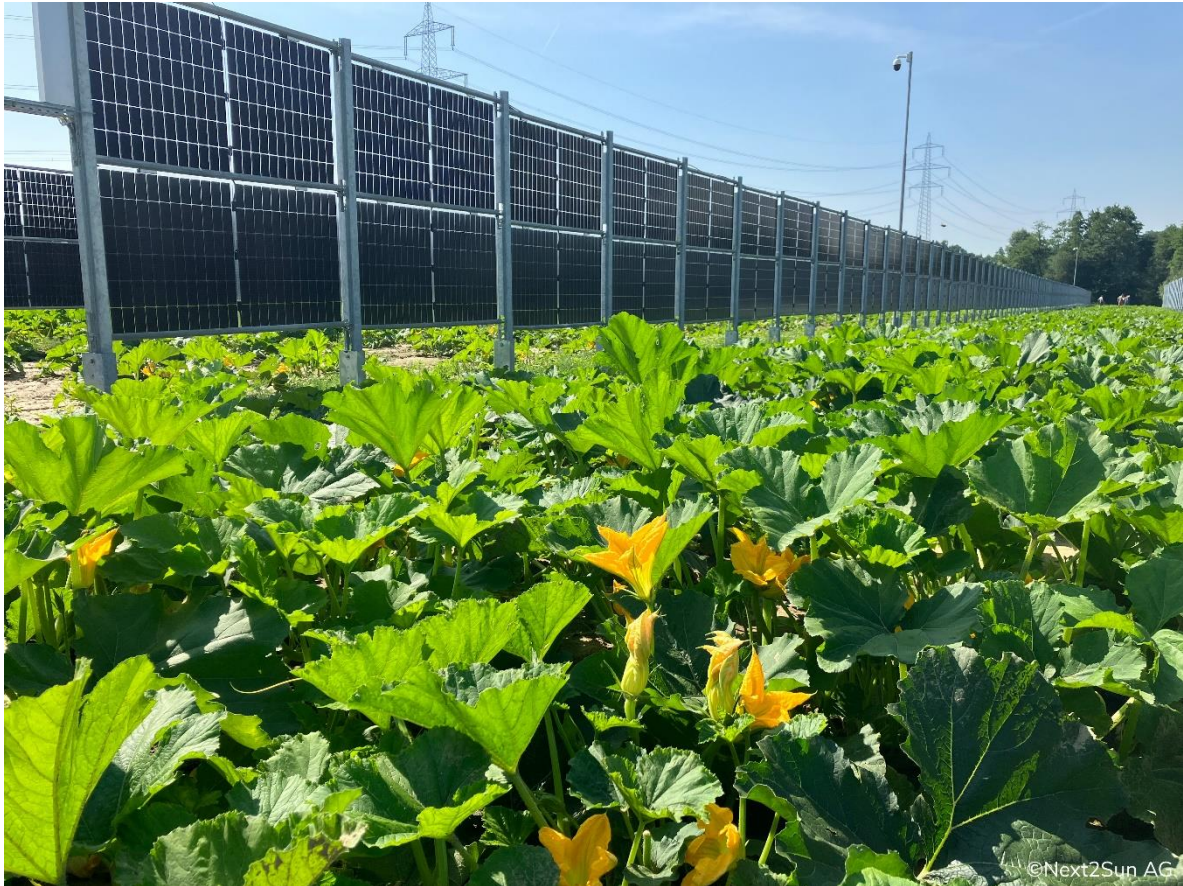
Abbildung 15: Die vertikale Agri-PV-Anlage im steirischen Gabersdorf ist hier während der Kürbisblüte zu sehen.
