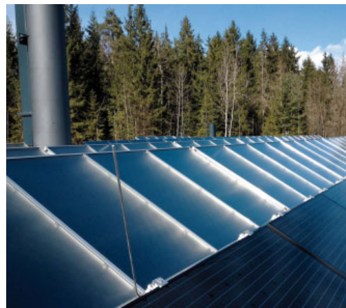
Solarthermie und PV-Anlagen am Dach des Heizwerkes
