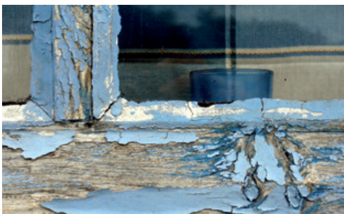
Abblättern von lackierten Oberflächen im Außenbereich
