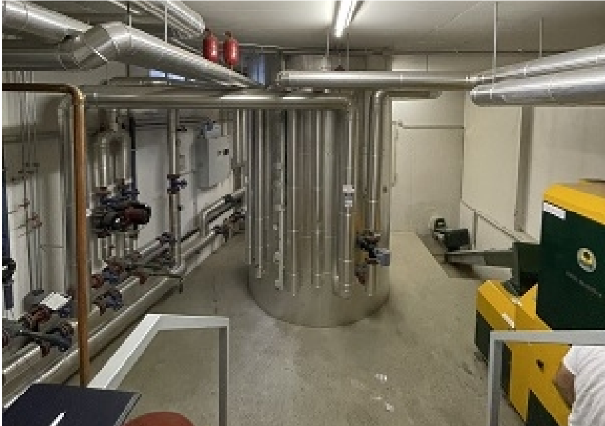
Abbildung 5: Einblick in den Technikraum
