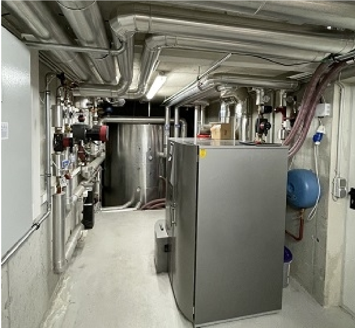
Abbildung 8: Einblick in den Technikraum
