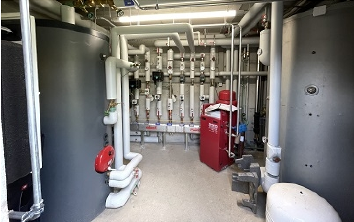
Abbildung 20: Einblick in den Technikraum
