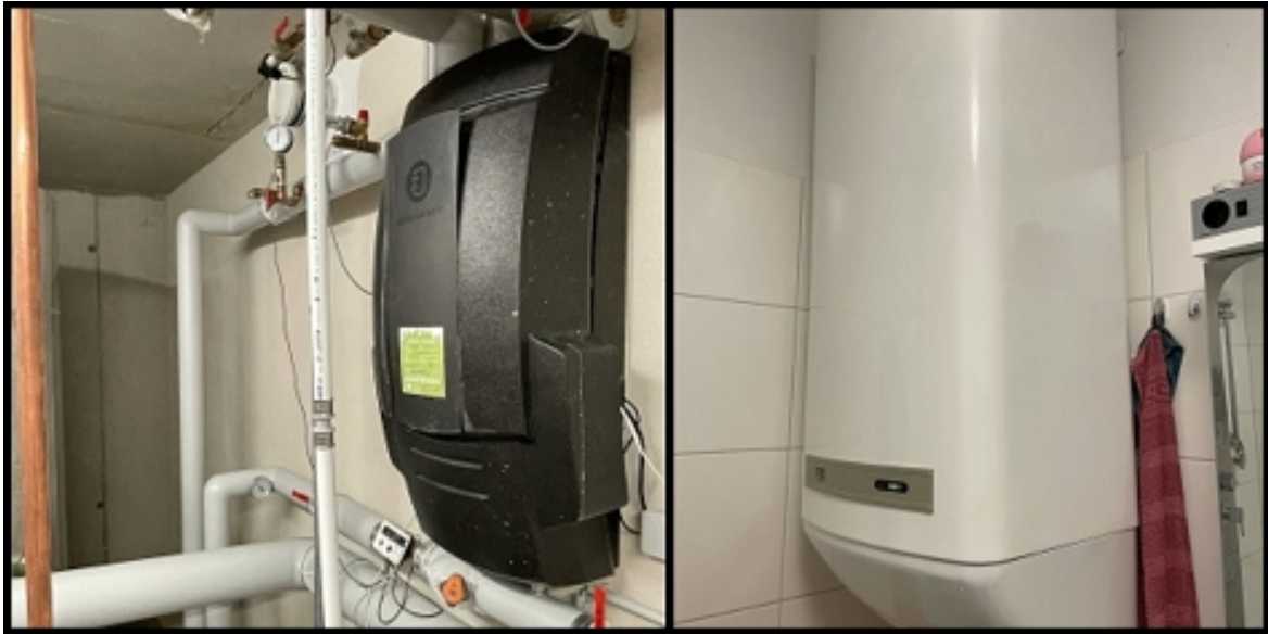
Abbildung 36: Solarstation sowie Fernwärme-Speicher
