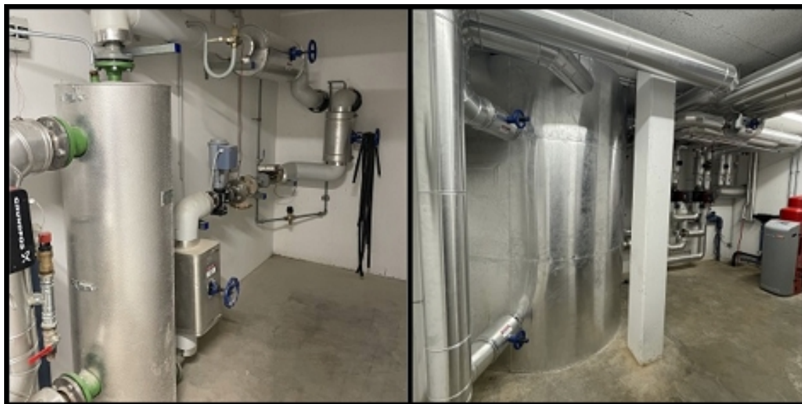
Abbildung 39: Fernwärme-Übergabestation sowie Pufferspeicher und Heizkreise
