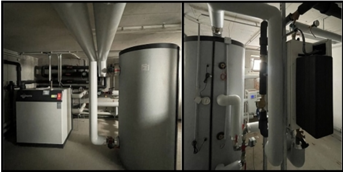
Abbildung 17: Wärmepumpe für den Heizbetrieb sowie Fernwärme-Anschluss, Pufferspeicher und Frischwassermodule für den WW-Betrieb
