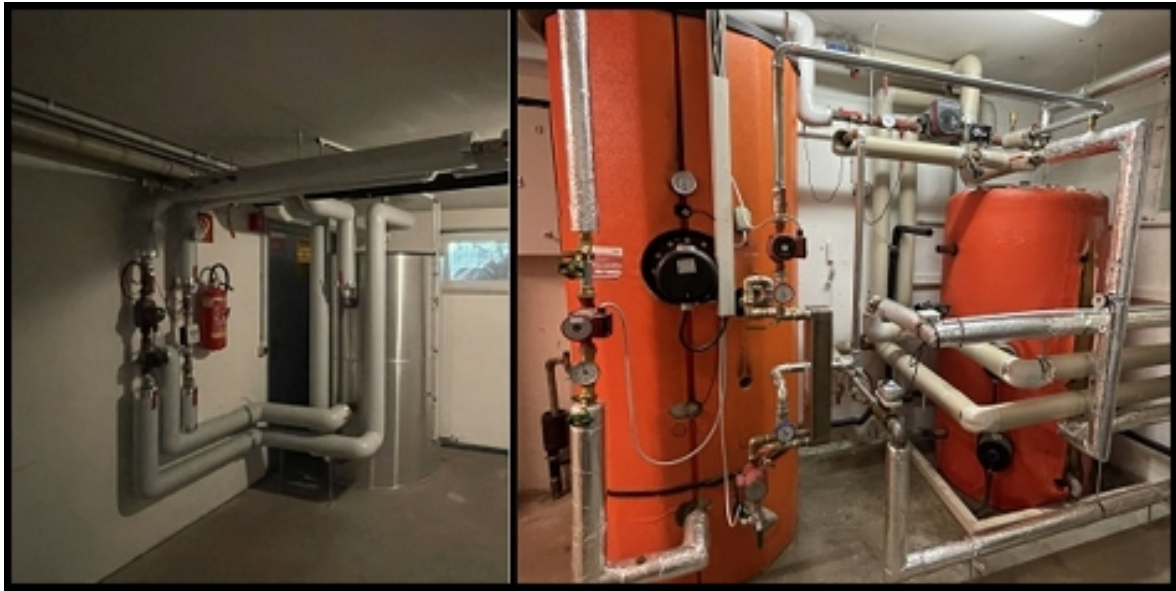
Abbildung 3: Pufferspeicher neben dem (nicht zugänglichen) Heizraum sowie Einblick in einen der Heizräume mit zentralem Warmwasserboiler
