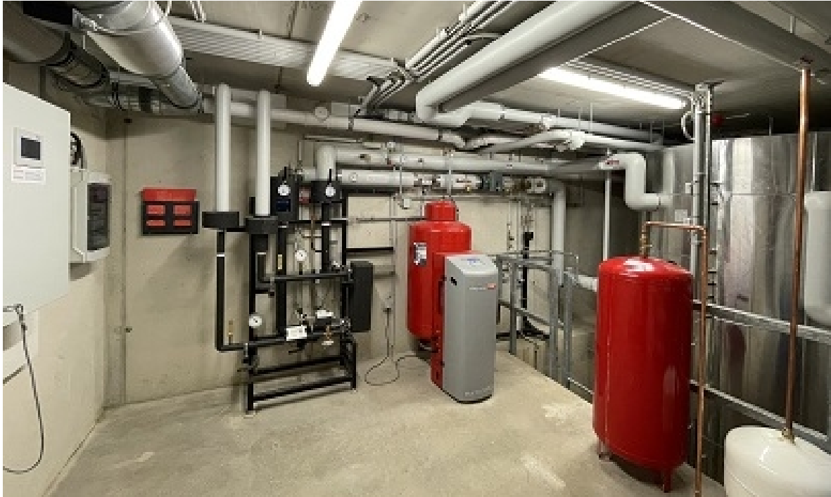
Abbildung 35: Fernwärme-Übergabestation (links) und Pufferspeicher (rechts)
