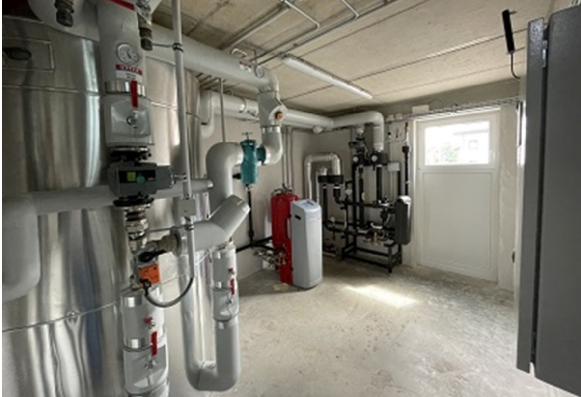
Abbildung 43: Einblick in den Technikraum von Wohnhausanlage 11.3
