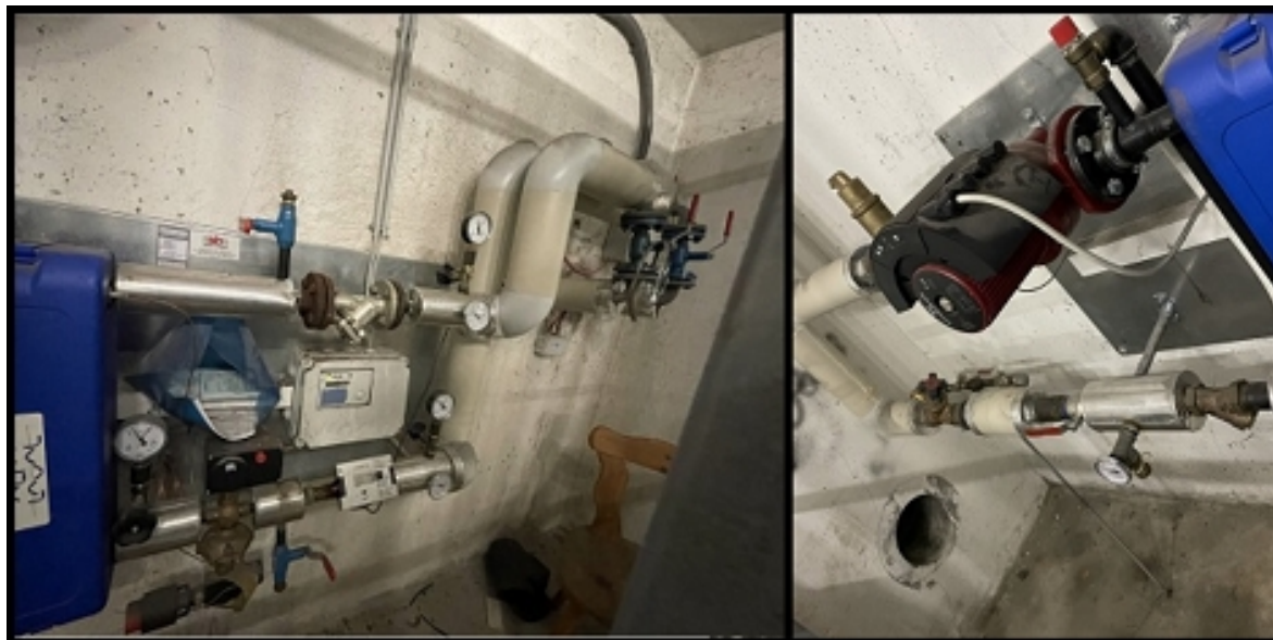
Abbildung 45: Fernwärme-Übergabestation sowie Heizkreispumpe (sekundärseitig)
