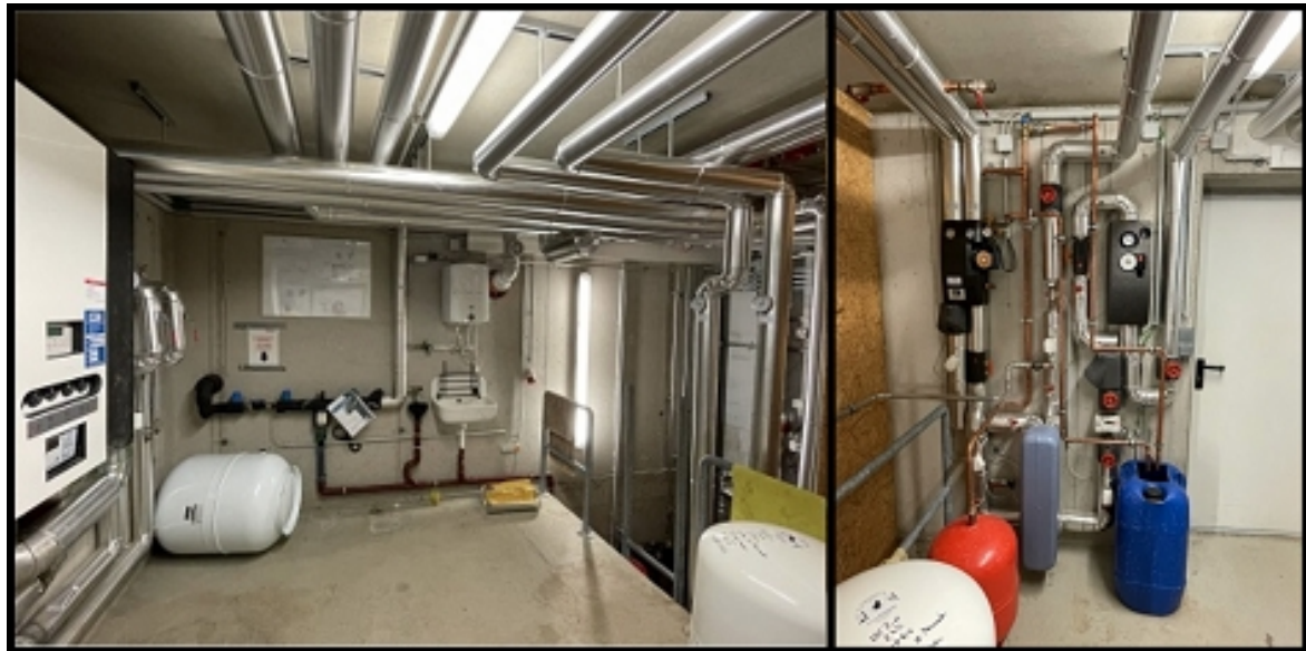
Abbildung 22: Fernwärme-Übergabestation, Pufferspeicher und Solarstation
