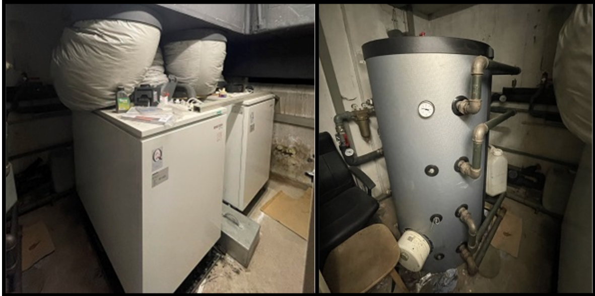
Abbildung 11: Luft-Wasser-Wärmepumpen und Pufferspeicher im Haus A
