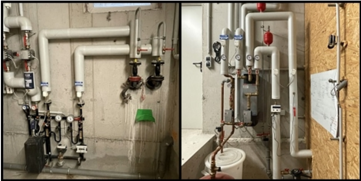
Abbildung 28: Fernwärme-Übergabestation sowie Solarstation
