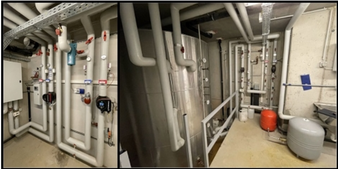
Abbildung 31: Fernwärme-Übergabestation und Heizkreise sowie Solarstation und Pufferspeicher
