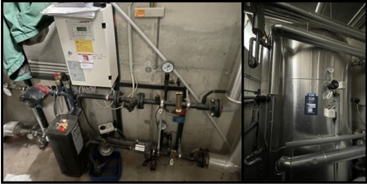
Abbildung 25: Fernwärme-Übergabestation sowie Pufferspeicher mit 3 Stück Elektro-Zusatzheizungen
